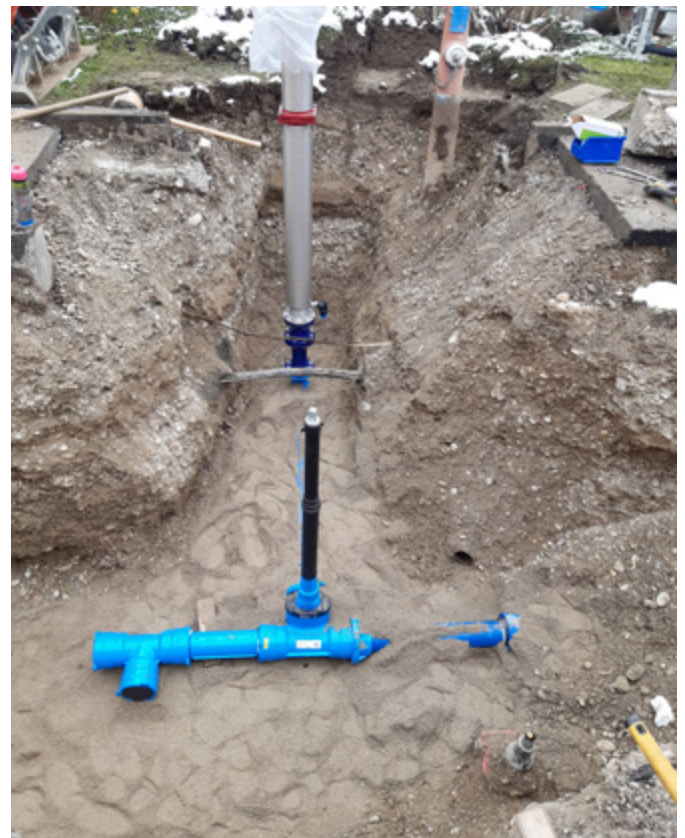
Die Baugrube hat die Abteilung Straße & Tiefbau des Stadtwerke Bereichs Betriebshof vorbereitet. Die Wasserrohre erneuert die Abteilung Trinkwasser.
