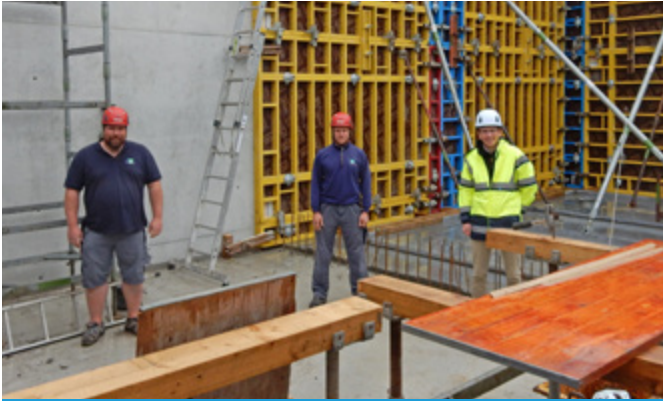
Hier wird künftig der Klärschlamm entwässert, von links: Sebastian Feigl, Abteilungsleiter Abwasserkanalsystem; Alexander Fath, Abteilungsleiter Kläranlage, Stefan Hartmann, Bereichsleiter Wasser & Abwasser, alle Stadtwerke Weilheim
